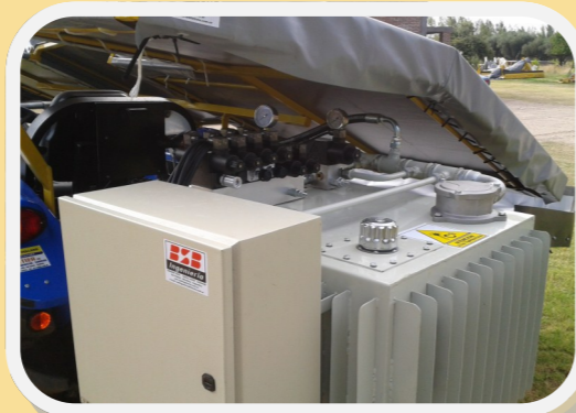
Central oleohidráulica para el accionamiento del vibrador y de los distintos movimientos de la máquina
